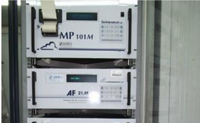
Figura 11 - Exemplo de analisadores de uma Estação de Monitorização da Qualidade do Ar de Lisboa e Vale do Tejo. Fonte: Câmara Municipal da Amadora (2021)
